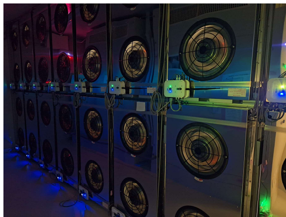
図 5. 大改修後、全面稼働再開した FFU と FFU 制御ユニット V2
