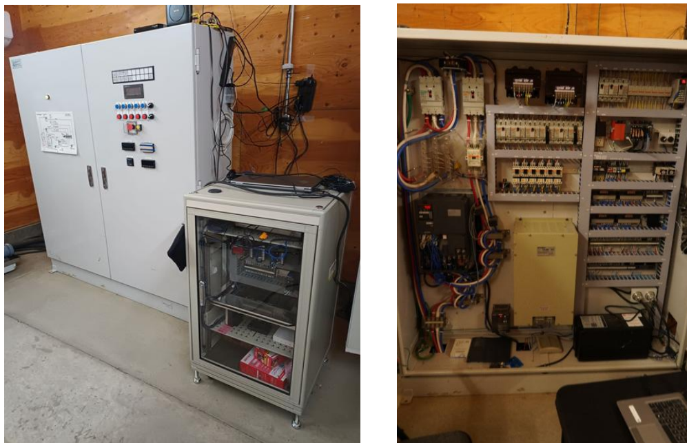
図 3 接地した新型制御装置（左）とインバーターを置き換えた既存制御盤（右）
