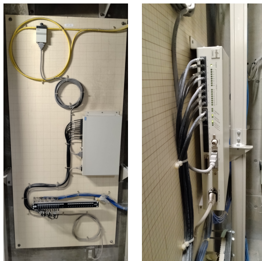
図3 イエローケーブルと AUI ポート付きハブ（工学部 1 号館）
