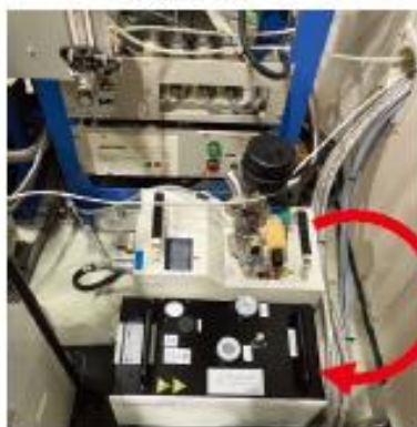
DSシャッターの 真空ポンプ
