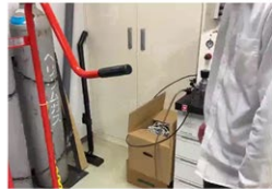
分電盤前の障害物
