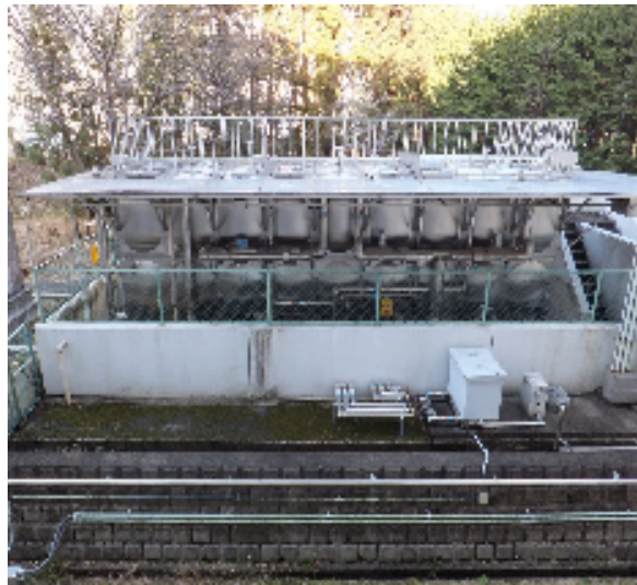
図2. 排水貯留槽 (9号)
